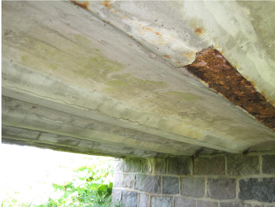
Foto 3: Bærende overbygning: Korrosion i indstøbte I profiler
