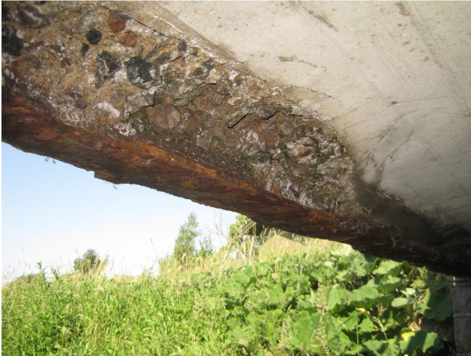
Foto 9: Bærende overbygning: Korrosion i indstøbte I profiler
