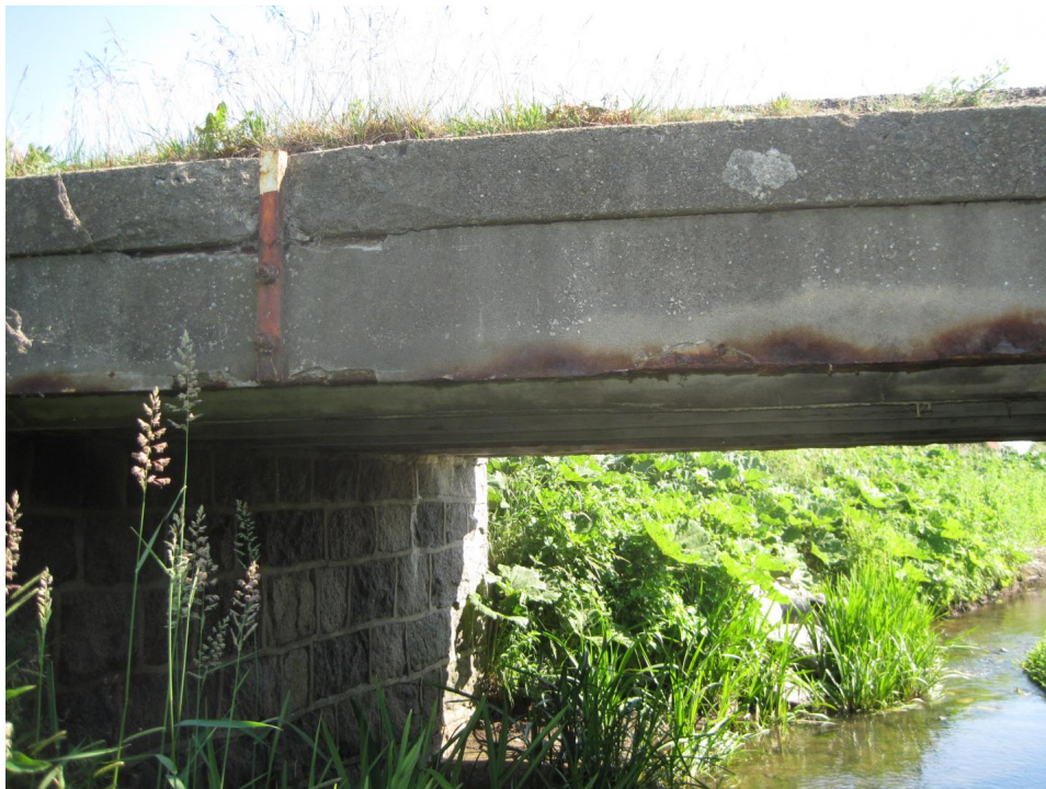
Foto 8: Bærende overbygning: Korrosion i indstøbte I profiler
