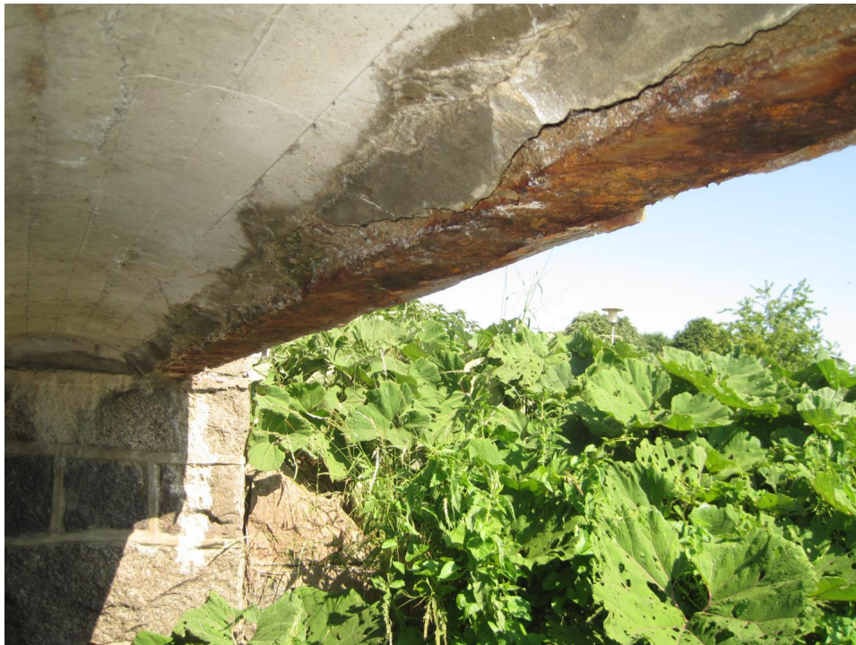
Foto 4: Bærende overbygning: Korrosion i indstøbte I profiler
