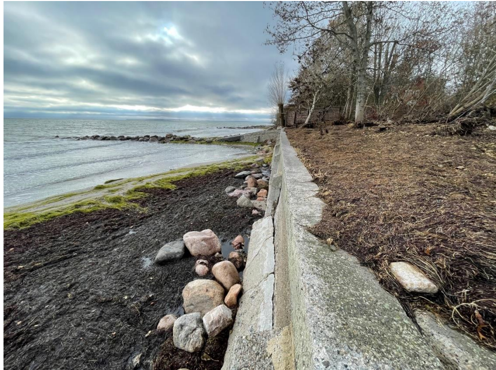
Figur 2-19 Nr. 9 efter stormflod, set mod syd. Erosion over muren og aflejring af store mængder tang over muren.
